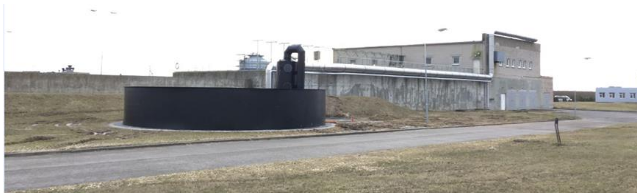
1.2.2.4 pav. Klaipėdos m. nuotekų valyklos pritekėjimo kameros oro valymo įrenginys (biologinis filtras).
